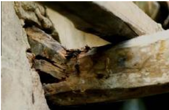
Fig. 17. Beam end decay [15].
